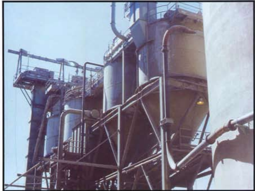
Système de manutention et d'entreposage de ciment sec
